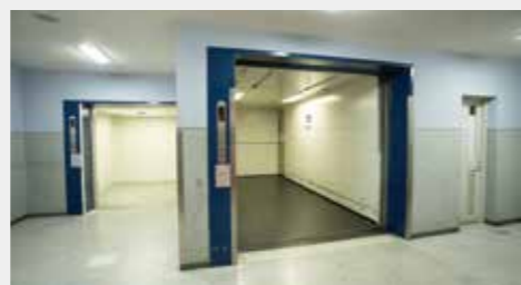
荷物用エレベーター Elevator for Loading
